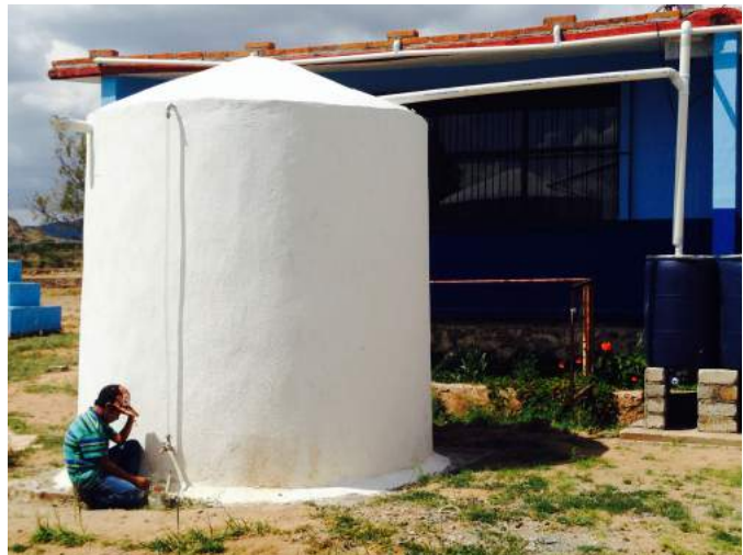
Figura 3.7 — Cisterna de agua de lluvia de 12,000 litros con un primer separador de aguas de 200 litros.
