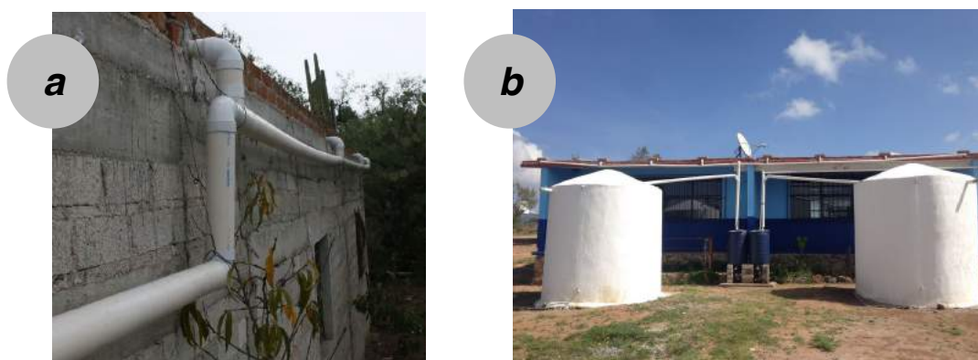
Figura 4.3 — (a) El sistema de tuberías está conectado a cuatro piezas de PVC de 2 "que llevan el agua del techo. La tubería se mantiene en su lugar mediante un murete de dos hiladas de ladrillo. En (b), un techo de concreto plano está conectado a dos cisternas.
